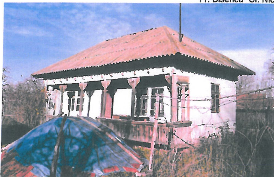
12. Casă cu arhitectură tradițională, DC 1536
